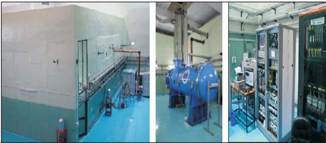
40 kW टोस अवस्था आरएफ प्रवर्धक के साथ एच.टी.एस. मेहराब। एच.टी.एस. क्रायोस्टैंट तथा LLRF एवं नियंत्रण प्रणाली
